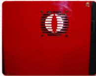
فن تهویه تابلو برق
