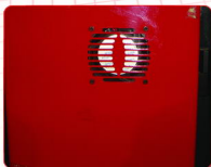
فن تهویه تابلو برق
